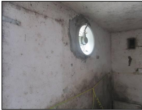
项目化学品仓储排气扇
