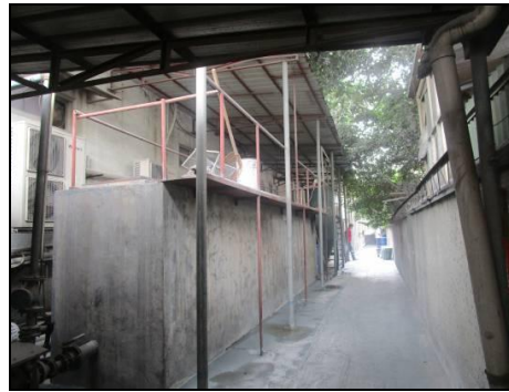
项目喷漆废水回用设施
